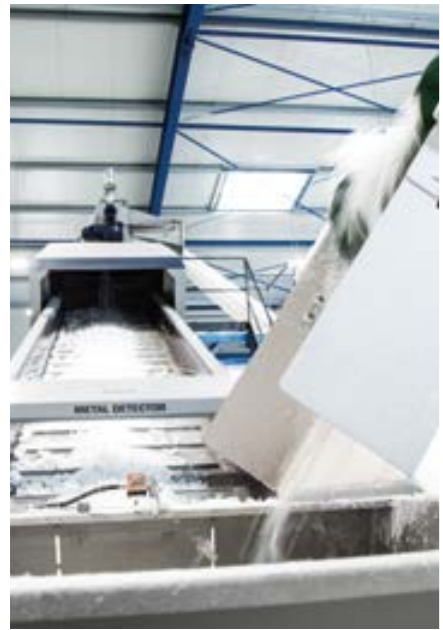
Lindner Antares e INTAREMA® TVEplus® montadas en la misma sala de máquinas: La trituradora suministra las escamas de film trituradas a la cinta transportadora de la máquina de EREMA.
